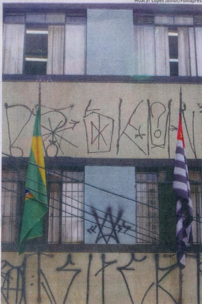
Prédio onde fica o fórum da Lapa com paredes pichadas
